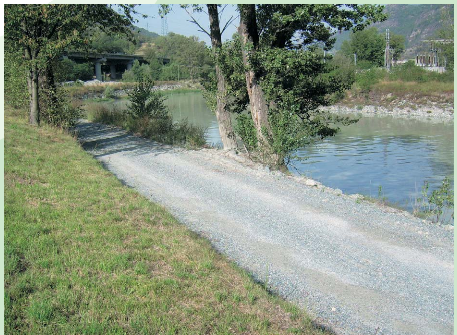
Sotto: Vista della strada comunale lungo Dora prima dei lavori (sono previsti: ampliamento, asfaltatura, ed inserimento guard rails)
